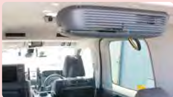
天井に設置された空気清浄機
